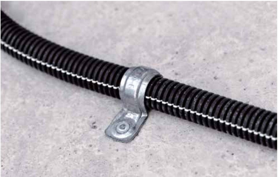
(a) Conduit support
